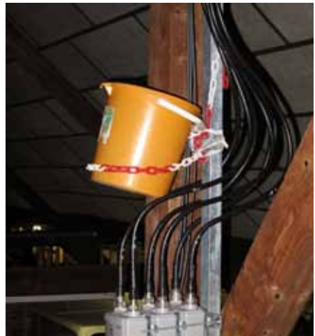
Die HiTech-Wasserefassung unter der Dachantenne. Nach monatelangen «Dichtungs-Versuchen» tröpfelt es nicht mehr in den Kübel – für wie lange wohl?
